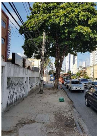
Figura 7 - Irregularidades na calçada na Avenida Domingos Ferreira
